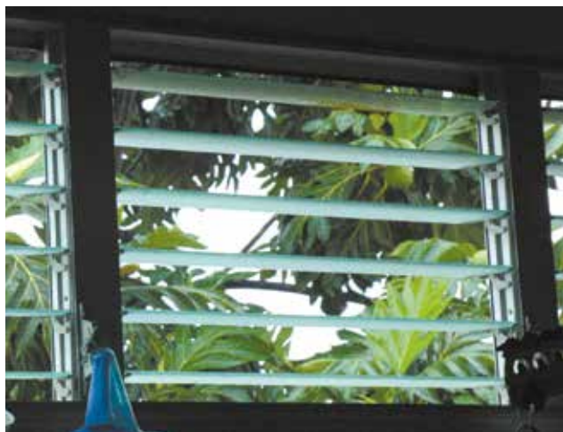
Les fenêtres à vantelles, une solution efficace pour bien ventiler les pièces non climatisées.
